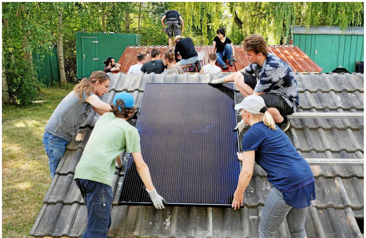
Bodennah wird im Camp geübt, wie man die 20 Kilogramm schweren Solarmodule auf Ziegel- oder Blechdach befestigt.
